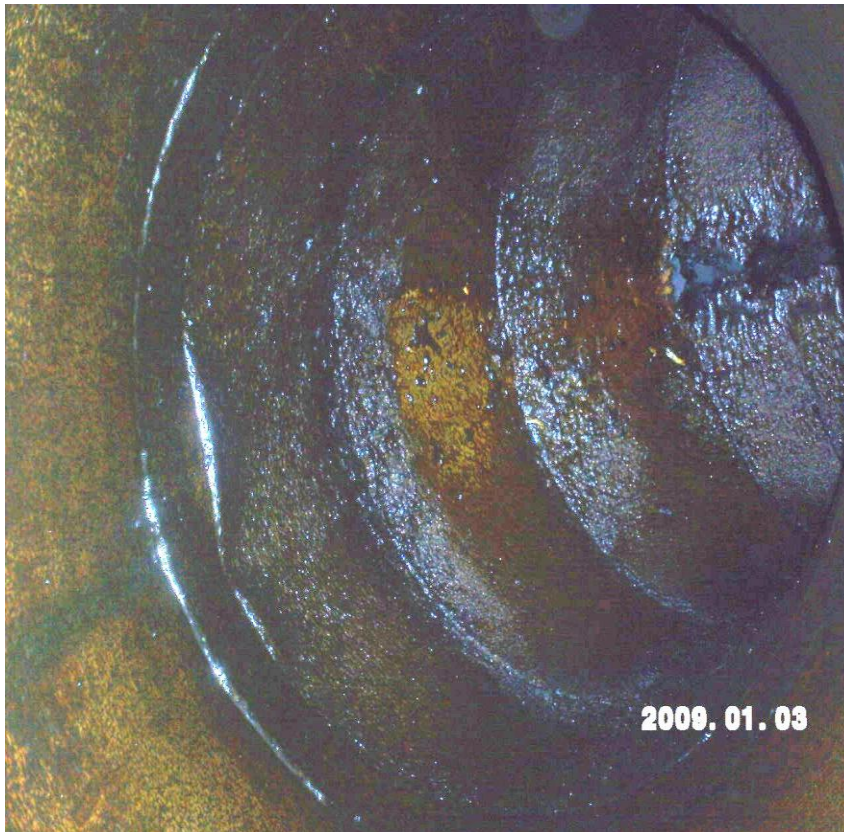
Ducto con grasa y lodos aceitosos
