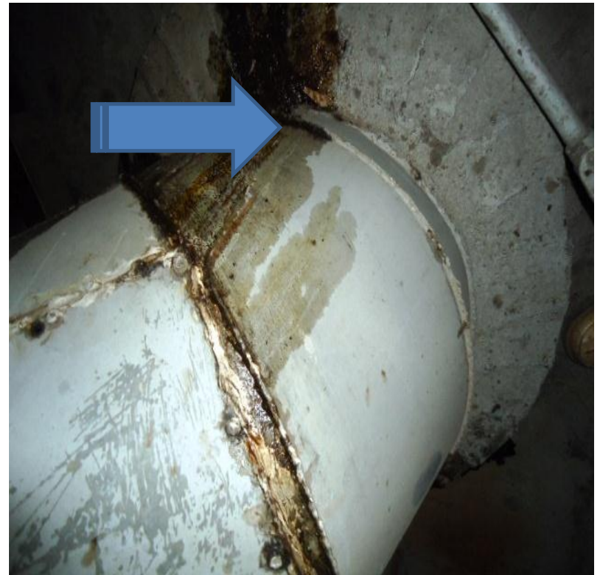
Tranferencia al extractor mal sellada
