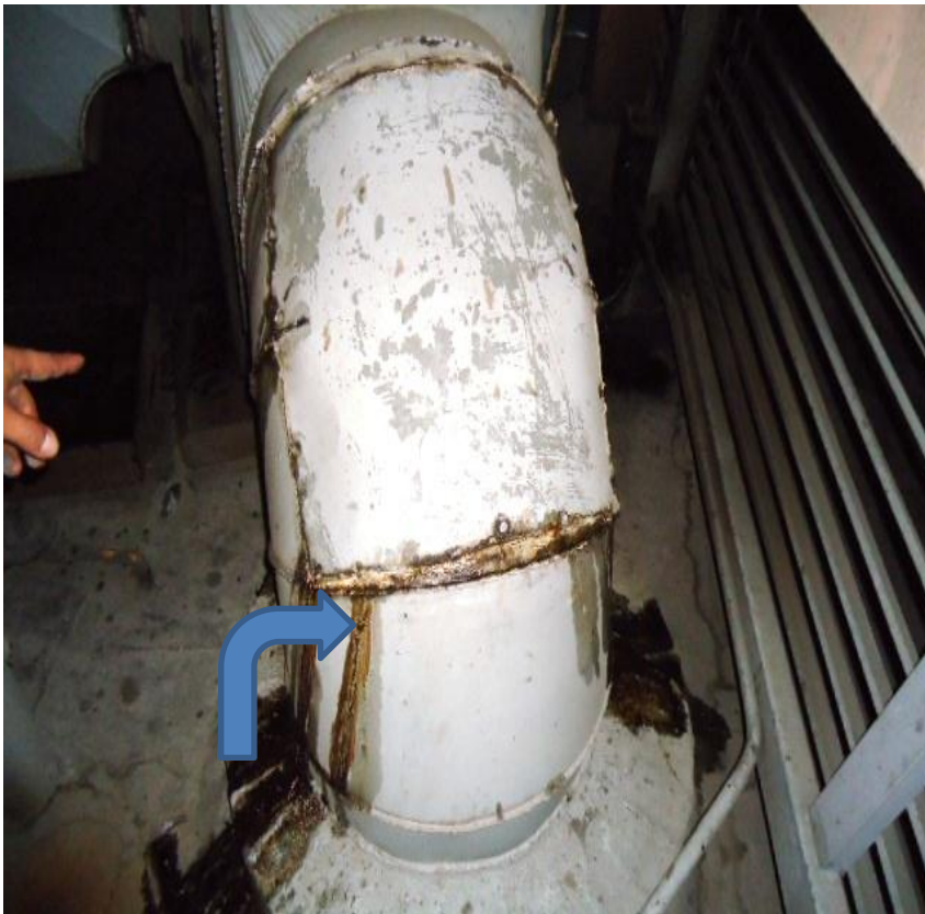
Acceso en ducto mal sellado
